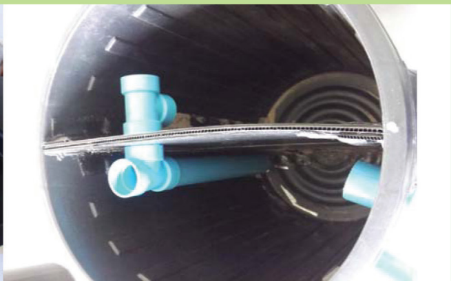
รูปที่ 5. ถังดักไขมัน
